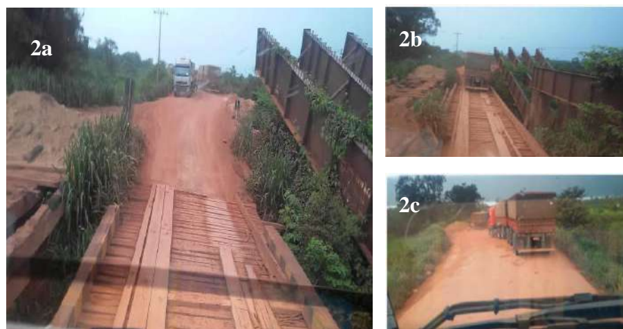
Figura 2a, 2b e 2c: Ponte próxima a Casa de Tábuas, trecho crítico do trecho até a comunidade de Agrovila. (André Lúcio, 2015).
